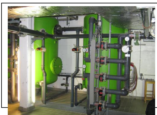
Filteranlage zu o.g. Beispiel
