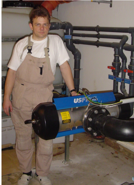
Abb. 4: Betriebstechniker des Beispielbades auf der Insel Usedom mit einer Mitteldruck UV-Anlage.
