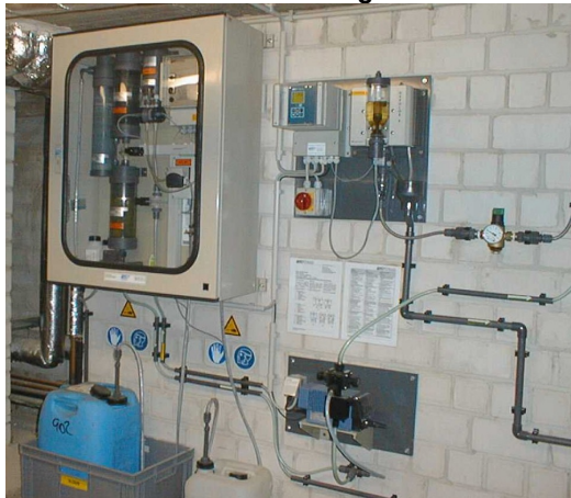
Abb.2: Chlordioxid-Bereitungs- und Dosieranlage mit selektiver ClO 2 - Messung. Foto: Arnim Beyer
