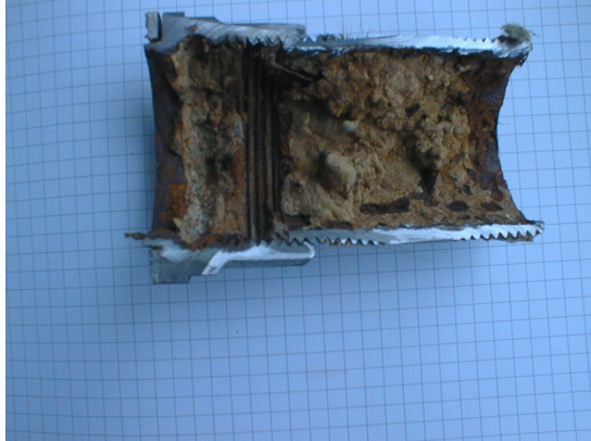
Abb. 1: Verzinktes Wasserrohr, ca. 30 Jahre in Betrieb. Foto: Arnim Beyer.
